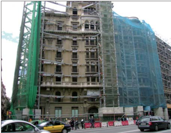
Estado anterior de la fachada del edificio
